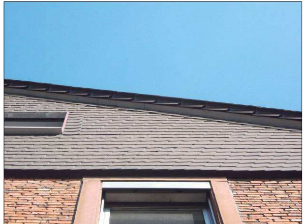
Abb. 14: Abstehende Dachschindeln des ehemaligen Verwaltungsgebäudes
